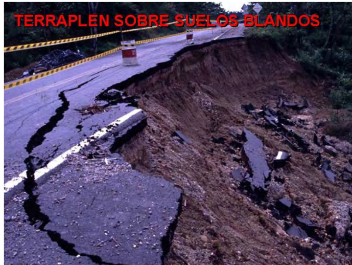
Falla estructural en carretera en Colombia
