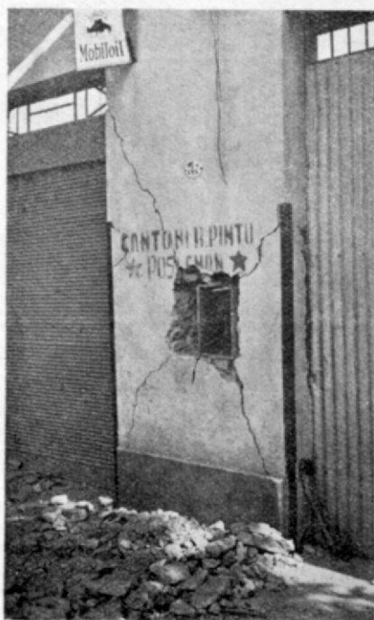
Fig. 53. — Sistema de grietas conjugadas con inclinación de 45^\circ que se cortan en el lugar del contador de la luz eléctrica. Este sistema de grietas se halla entre dos aberturas. Calle 25 de Mayo, N° 747. (Fotografía Castellanos)
