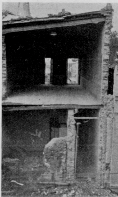
Fig. 48. — Casa ubicada detrás de la Catedral y con frente a la calle Rivadavia. La pared frontal caída. (Fotografía Castellanos)
