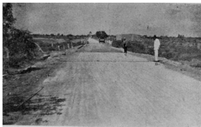
Fig. 95. — Trozo de camino al N.E. del puente carretero (A) y puente del canal Caucete (B). Una grieta (C), donde está de pie el señor Rubies marca un desnivel de 0m.20. Entre B y C está la parte hundida. En D hay otra grieta, de pie sobre ella el Ing. Ramón Flores. (Fotografía Castellanos)
