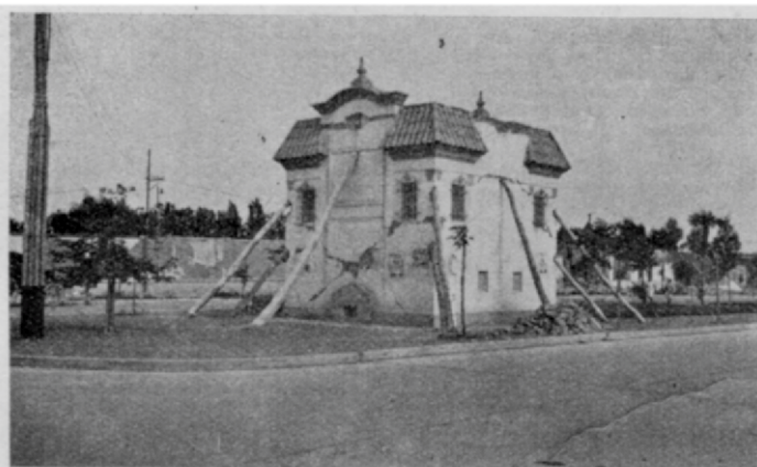
Fig. 62. — Edificio de la subestación Mitre. Sociedad de Electricidad Los Andes. Avda. San Martín (límite de la ciudad con el barrio Santa Lucía). Grieta horizontal en la parte superior, otras conjugadas con inclinación de 45° y las más numerosas terminan en los ángulos de las ventanas. (Fotografía Castellanos)
