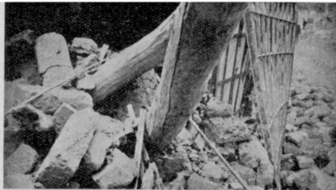
Fig. 78. — Escombros de un convento. Vigas de madera agrietadas. Enero 16. (Fotografía Ronchietto)
