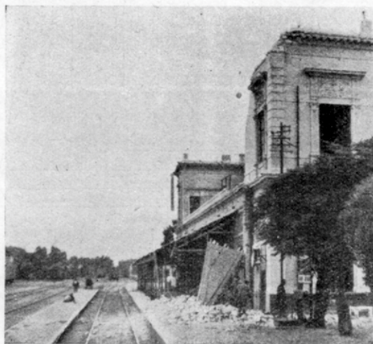
Fig. 5. — Estación del F. C. al Pacífico en San Juan, después del terremoto. En la actualidad está demolida por no ofrecer seguridad
