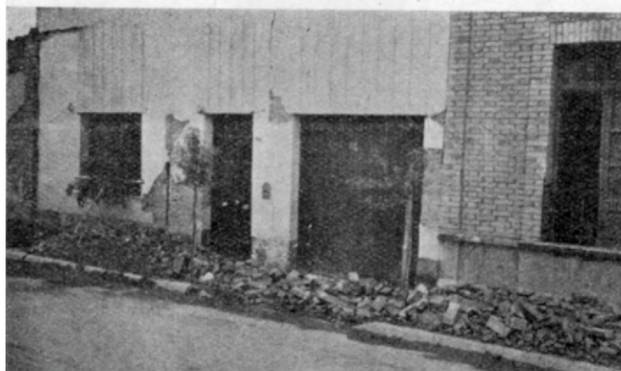
Fig. 56. — Casa en la calle Tucumán N° 435, entre Chile y Benavidez. Una grieta vertical separa la puerta de calle del garage. Entre la puerta y la ventana aparecen grietas conjugadas de 45° de inclinación. Una grieta horizontal provocó el derrumbe de la cornisa. (Fotografía Castellanos)
