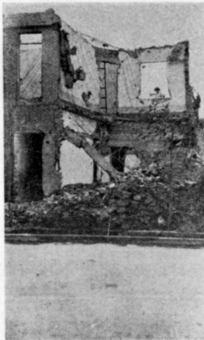
Fig. 15. — Casa de ladrillo, medianera de adobe; techo de una loza de hormigón armado que ha quedado sólo el enrejado después del sismo. Avda. de Mayo entre Rioja y Jujuy. (Fotografía Castellanos)
