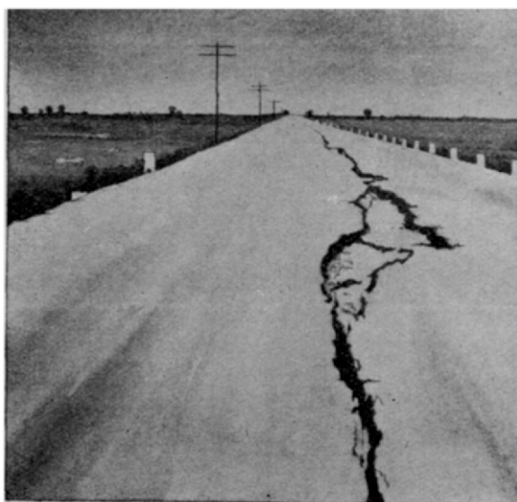
Fig. 104. — Grietas longitudinales en el camino cerca del puente "Nueve de Julio", sobre el río San Juan
