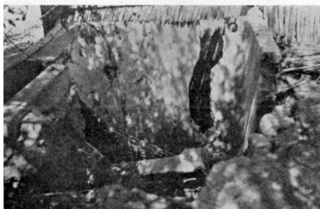
Fig. 102. — Casa de Félix Herrero, en Albardón. Grietas de W. a E., con rechazo, que muestran las piletas de decantación. (Fotografía Castellanos)
