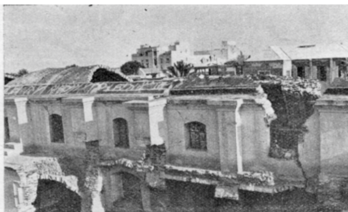
Fig. 70. — Techo en bóveda de la Catedral, caído. Rivadavia es- quina Mendoza, frente a la plaza 25 de Mayo. (Fotografía Rubíes)
