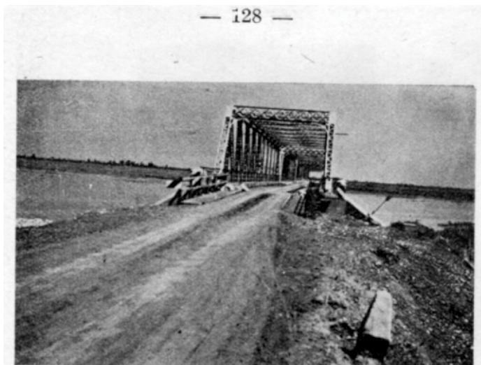
Fig. 90. — Puente carretero sobre el río San Juan, Alto de Sierra. Muestra la grieta en el estribo de la margen izquierda. (Fotografía Castellanos)
