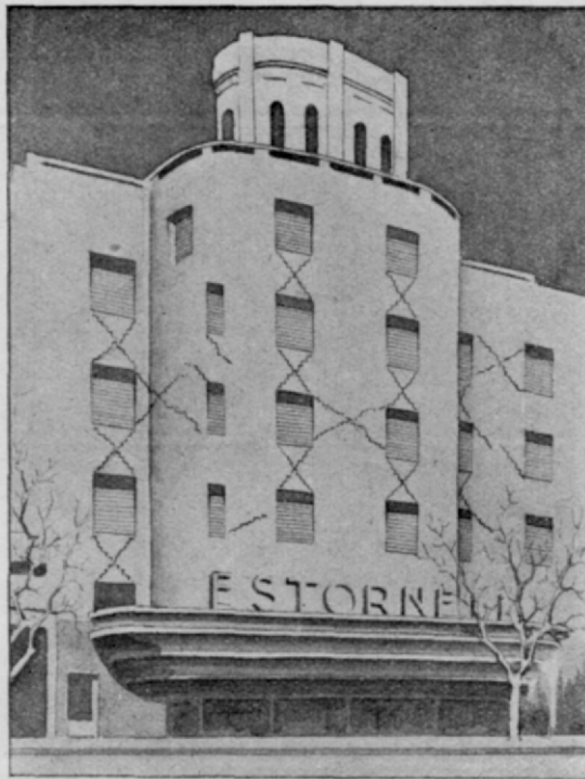
Fig. 41a. — Teatro Estornell. Dibujo que indica las grietas producidas en la fachada durante el sismo
