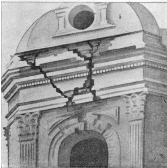
Fig. 68. — Una de las torres de la Catedral. Detalle de las grietas sobre la abertura del campanario que mira (calle Mendoza) a la plaza 25 de Mayo
