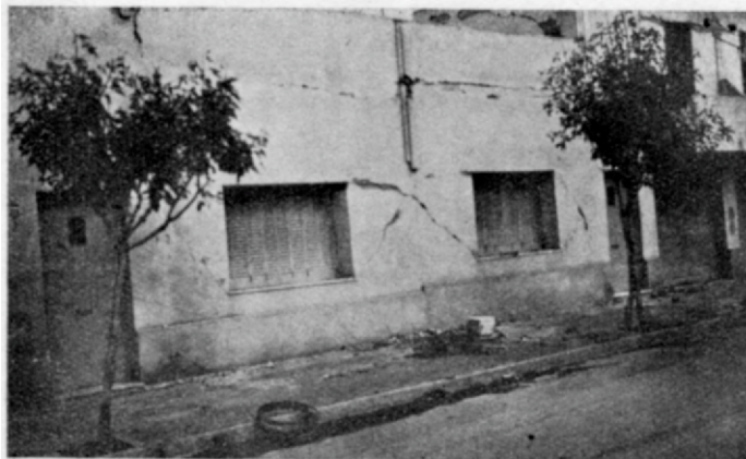
Fig. 55. — Casa en la calle Rioja, Nos. 271-279, al lado de la anterior. Se aprecia, arriba, una grieta horizontal y abajo, entre las ventanas y puertas, otras conjugadas de 45° de inclinación. (Fotografía Castellanos)
