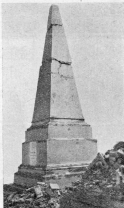
Fig. 87. — Pirámide de ladrillo perteneciente a un mausoleo en el cementerio de San Juan (1ª norma). Se aprecian las grietas horizontales y desplazamiento de las secciones. (Fotografía Castellanos)
