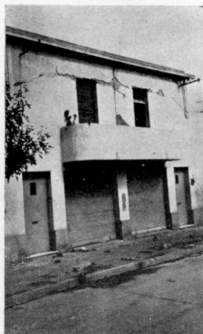
Fig. 54. — Casa situada al lado de un mercado, en la calle Rioja Nos. 271-279. En la parte superior hay una grieta horizontal y abajo otras con inclinación de 45^\circ . (Fotografía Castellanos)
