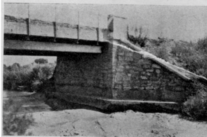
Fig. 94. — Puente sobre el canal Caucete. Obsérvase una grieta horizontal en la base. (Fotografía Castellanos)
