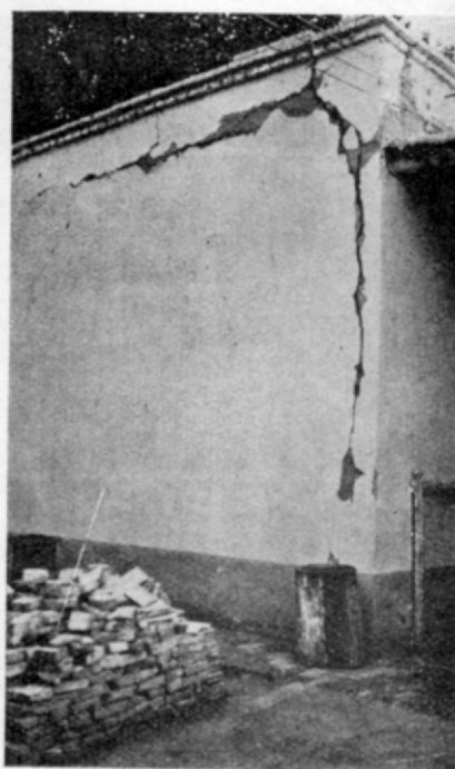
Fig. 113. — Pared orientada de N.W. a S.E. que mira al S.W., señalando dos grietas, una horizontal y otra vertical. Bodega de Grafigna, en Ullún. (Fotografía Castellanos)
