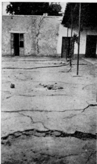
Fig. 112. — Patio de la casa de la señora Nieves C. de González, en Ullún. En el suelo se aprecian numerosas grietas paralelas, de dirección N.W. a S.E. y verticales normales a las anteriores en las paredes del edificio que mira al N.E. (Fotografía Castellanos)
