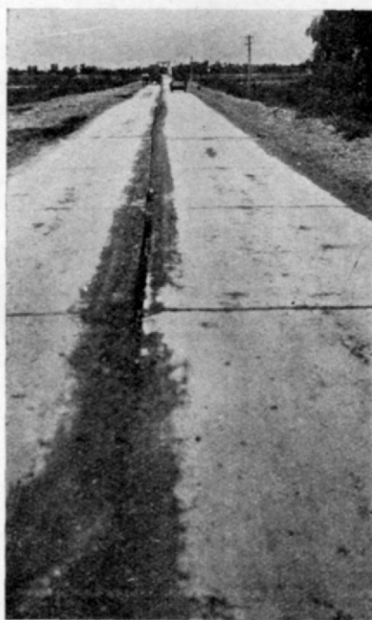
Fig. 96. — Camino de hormigón que muestra una onda gravífica y donde también se registran movimientos diferenciales. Trozo del camino a 1000 m. al N.E. del puente carretero de Alto de Sierra, sobre el río San Juan. (Fotografía Castellanos)
