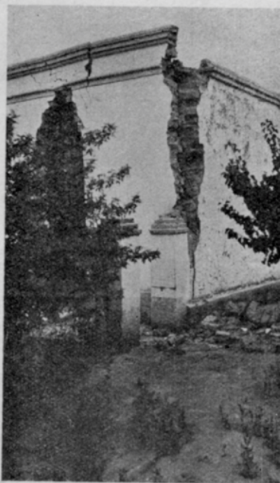
Fig. 110. — La misma grieta que continúa en la casa de la señora Nieves C. de González en Ullún. (Fotografía Castellanos)
