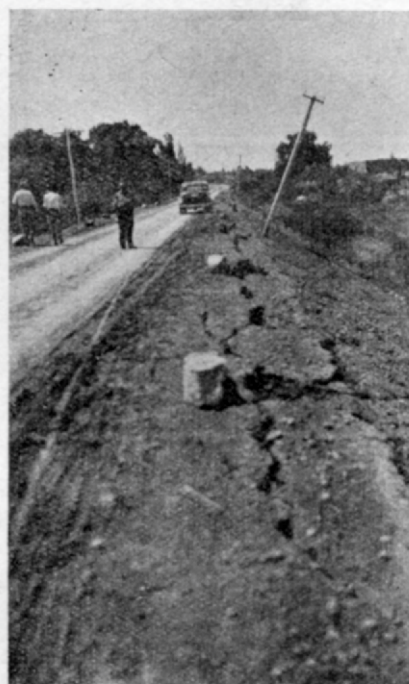
Fig. 93. — Grieta longitudinal en el terraplén del camino a la salida del puente carretero de Alto de Sierra. Trozo del camino comprendido entre este puente y otro sobre el canal Cauce. (Fotografía Castellanos)
