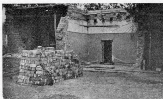
Fig. 114. — Pared del S.E. derrumbada en la bodega de Graffigna, en Ullún. (Fotografía Castellanos)
