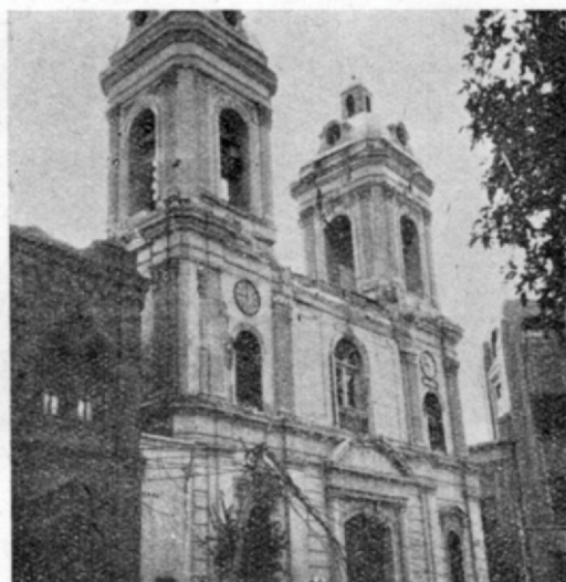
Fig. 65. — Frente de la Catedral sobre la calle Mendoza (N. a S.) mirando a la plaza 25 de Mayo. Se notan las torres desplazadas, derribadas después. Se observan grietas verticales arriba de las ventanas y de las aberturas de los campanarios. Enero 16. (Fotografía Rusconi)
