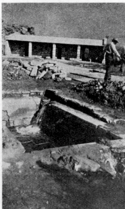
Fig. 21. — Baños de La Laja. Pileta agrietada, donde cae el agua sulfurosa destinada a los baños del hotel. (Fotografía Castellanos)
