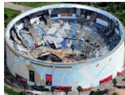
Luego del derrumbe del techo
