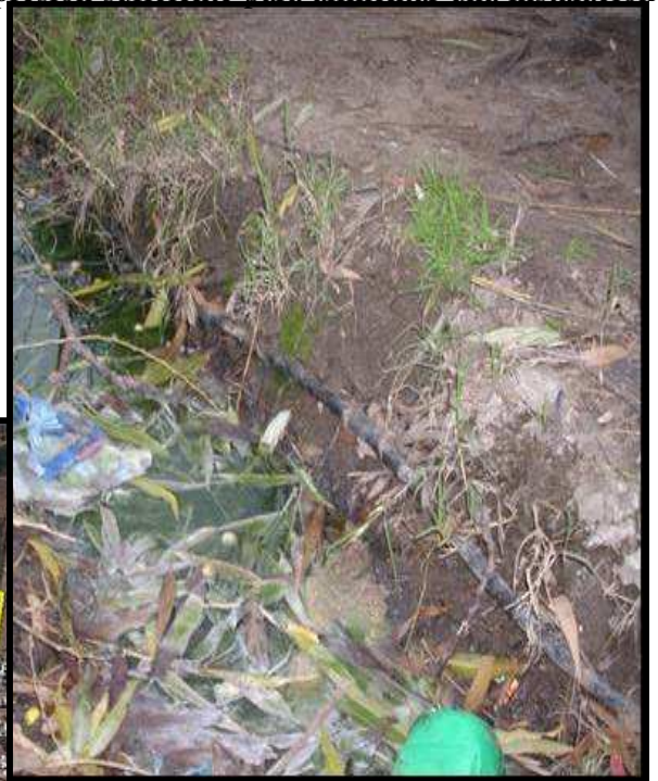
Figura 3. Tendido de red clandestino.
